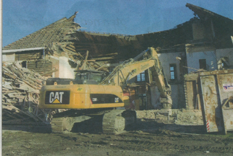
HISTORIE: Nordli ble revet i oktober i fjor. Rivingen vakte oppsikt både i og utenfor Sørum kommune. Den gamle bygningen skal erstattes med en kopi.
